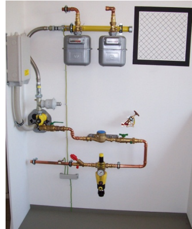
Beispiel einer Hausanschlusswand nach DIN 18012 mit Mehrspartenhausanschlüssen für Strom, Gas, Wasser, Kommunikationstechnik
