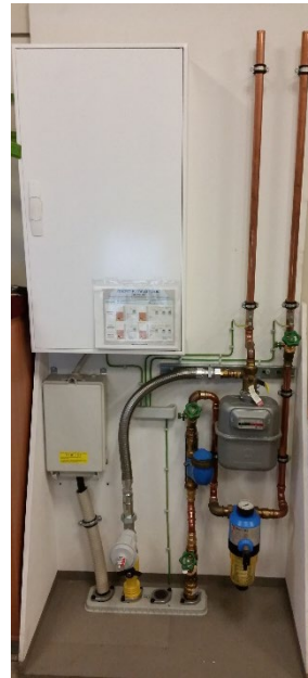
Beispiel einer Hausanschlussnische nach DIN 18012 mit Mehrspartenhausanschlüssen für Strom, Gas und Wasser, Kommunikationstechnik
